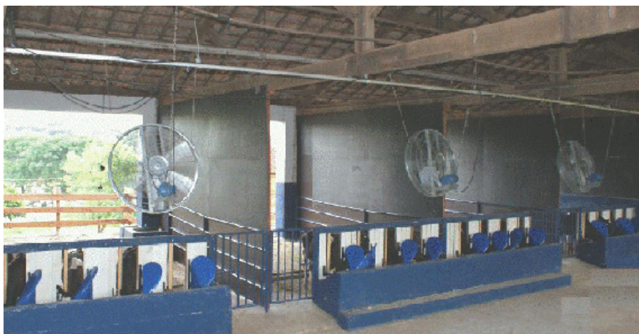
Figura 4 - Ventiladores em instalações animais. Fonte: Zotti (2010).
